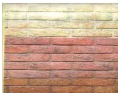
Gambar 15 : Bata beton ekspos yang dipasang mulai dari warna gosong sampai warna gosong
