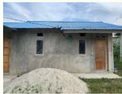
Gambar. 8. Huntap yang mengalami kerusakan
